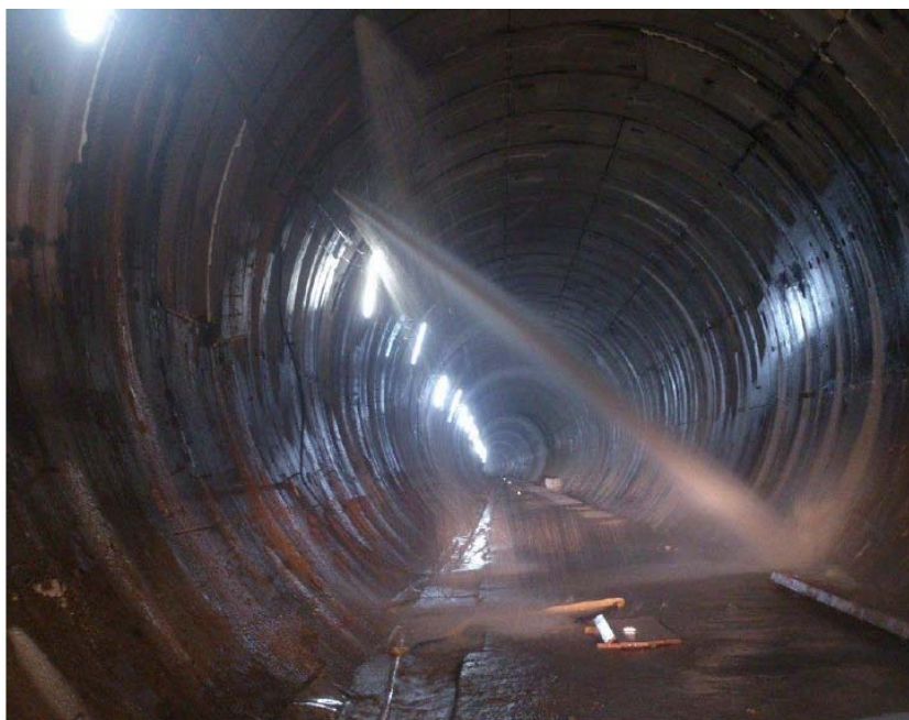
Slika 21 – Puščanje vode v predoru Pajares
